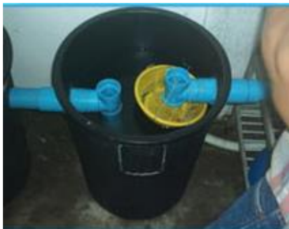
ภาพที่ 5-17 บ่อดักไขมันประดิษฐ์อย่างง่าย
